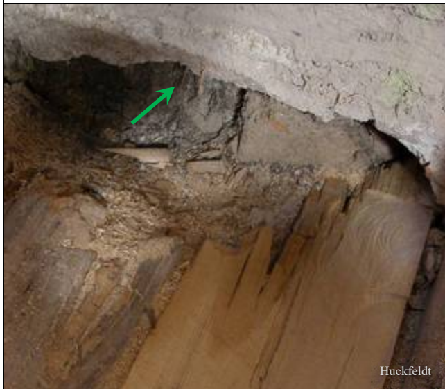
Abb. 5: Balkenaufleger mit Braunfäule; Mycel fehlt scheinbar auf den ersten Blick. Auf den zweiten Blick kann Mycel entdeckt werden (Pfeil).
