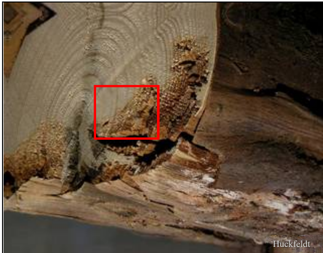
Abb. 1: Lagerholz mit Braunfäule; Mycel fehlt; die Probe sollte aus dem Übergang vom gesunden zum zerstörten Holz entnommen werden.
