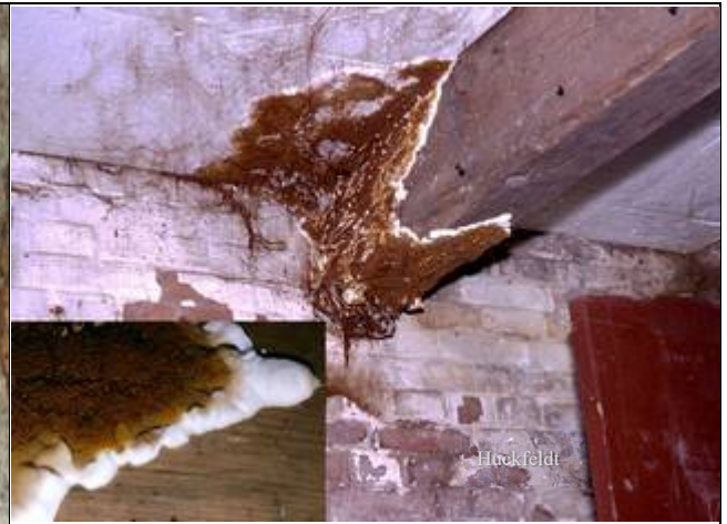
Abb. 2: Fruchtkörper des Echten Hausschwammes ( Serpula lacrymans ) an einer Kellerdecke; das Eckbild zeigt die braune Fruchtschicht – das Holz wird im Abbauprozess schwammig.
