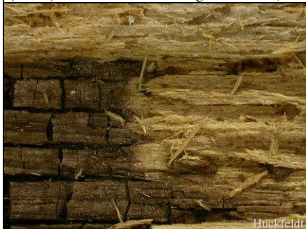
Abb. 4: Doppelbefall mit Echem Hausschwamm (Braunfäule, links) und Ausgebreitetem Hausporling (Weißfäule, rechts)
