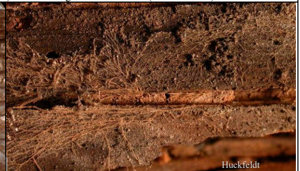
Abb. 6: Doppelbefall mit Echem Hausschwamm (Braunfäule) und Sternsetenpilz (braune Stränge); eine Weißfäule ist nicht erkennbar. Ein Doppelbefall mit Sternsetenpilz ist häufig.
