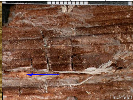
Abb. 5: Doppelbefall mit Kellerschwamm (Braunfäule) und Stachelsporling (weiße Stränge); bereichsweise ist eine Weißfäule (↑) erkennbar.
